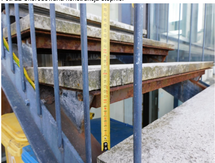
Fot. 23 Skorodowana konstrukcja stopnic.
