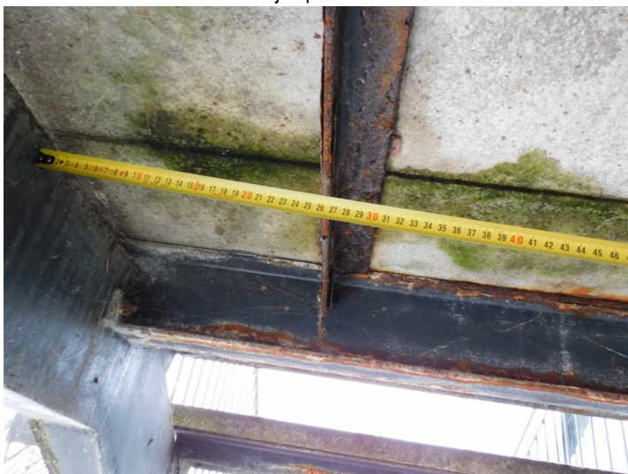
Fot. 19 Skorodowana konstrukcja spocznika i porażona biologicznie płyta betonowa spocznika.
