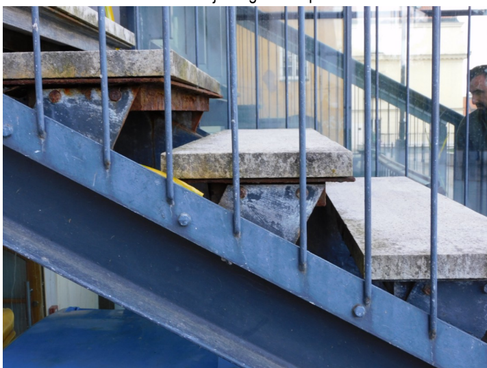
Fot. 22 Skorodowana konstrukcja stopnic.
