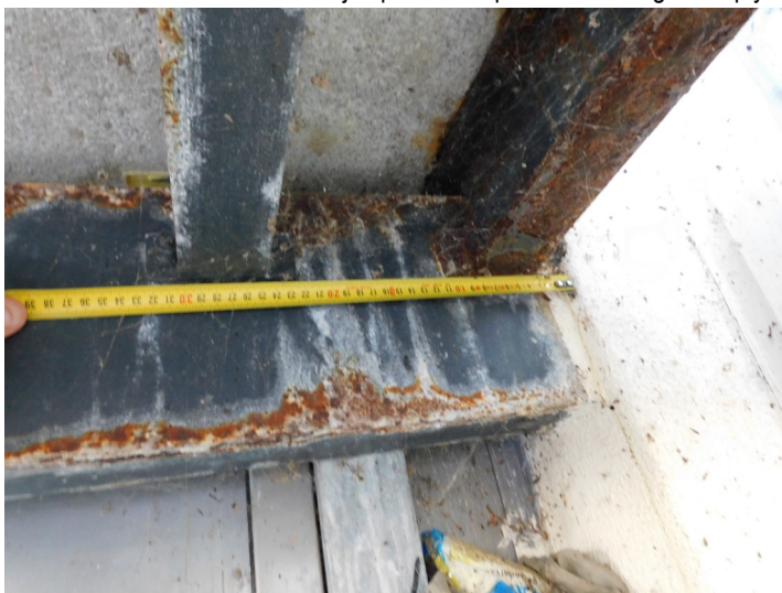
Fot. 20 Skorodowana konstrukcja spocznika i belki nośnej.
