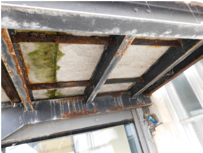
Fot. 18 Skorodowana konstrukcja spocznika.
