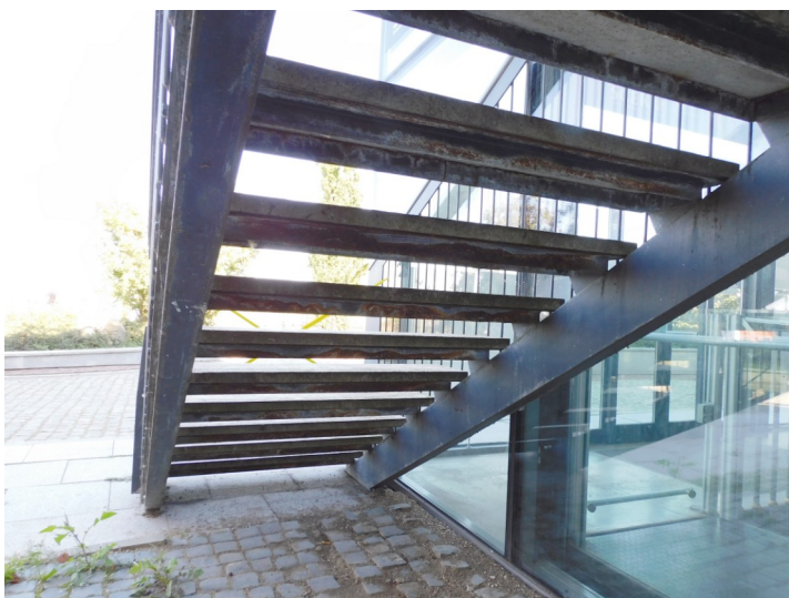
Fot. 21 Skorodowana konstrukcja biegów od spodu.
